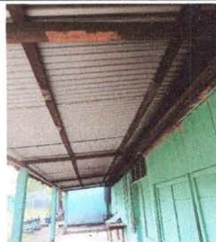
Foto 2: La sustitución se realizara por el mal estado de la madera debido al tiempo que lleva.
