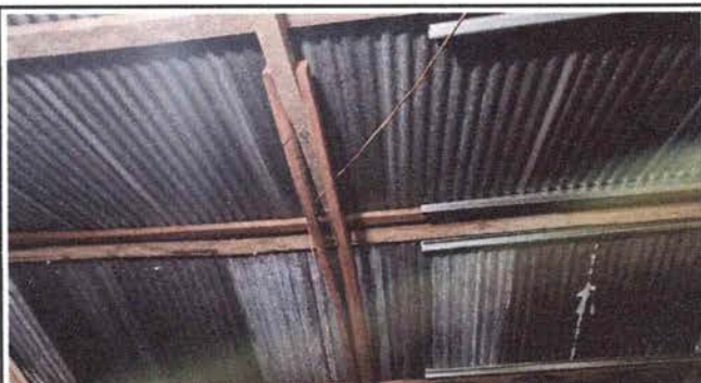
Foto 3: La sustitución de la estructura se debe a que la actual se encuentra en mal estado, pudiendo ocasionar algun accidente.
