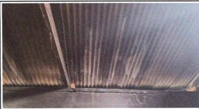
Foto 4: Se contempla la sustitucion de cubierta de lamina debido a que la actual lamina ya presenta orificios provocados por el desgaste que provoca la interperie
